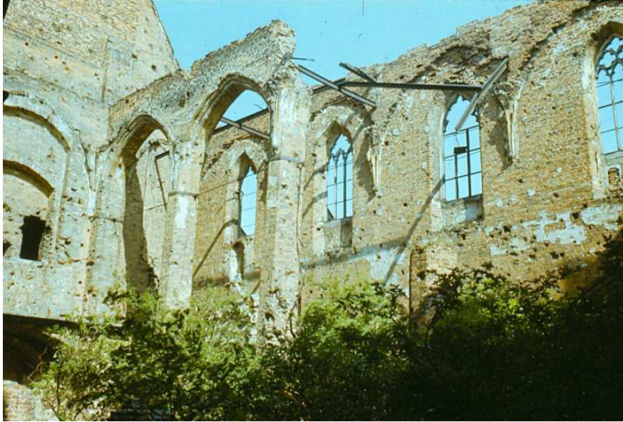
Zniszczone wnętrze korpusu i zarośla w nim w 1987 r.
