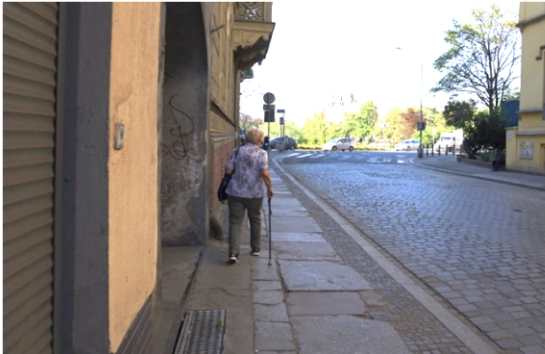
Rys.6 Nierówna nawierzchnia chodnika znacząco utrudnia lub uniemożliwia korzystanie z niego, ul. Dworcowa. Wrocław (zdj. autor)
